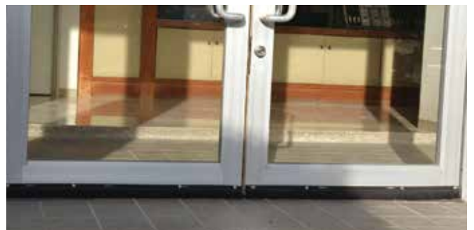
工場入口に近い扉にはブラシを設置
