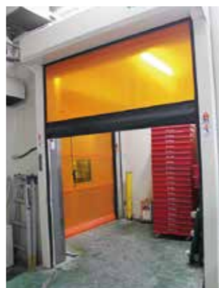
外気や虫をなるべく中に入れないよう搬入口、搬出口ともに、シートシャッターを二重に設置
