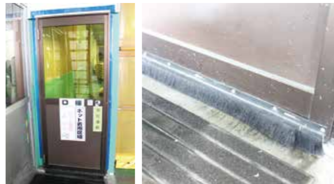
工場の通用口の下部に取り付けられた「バーカットフレックスシステム」。
